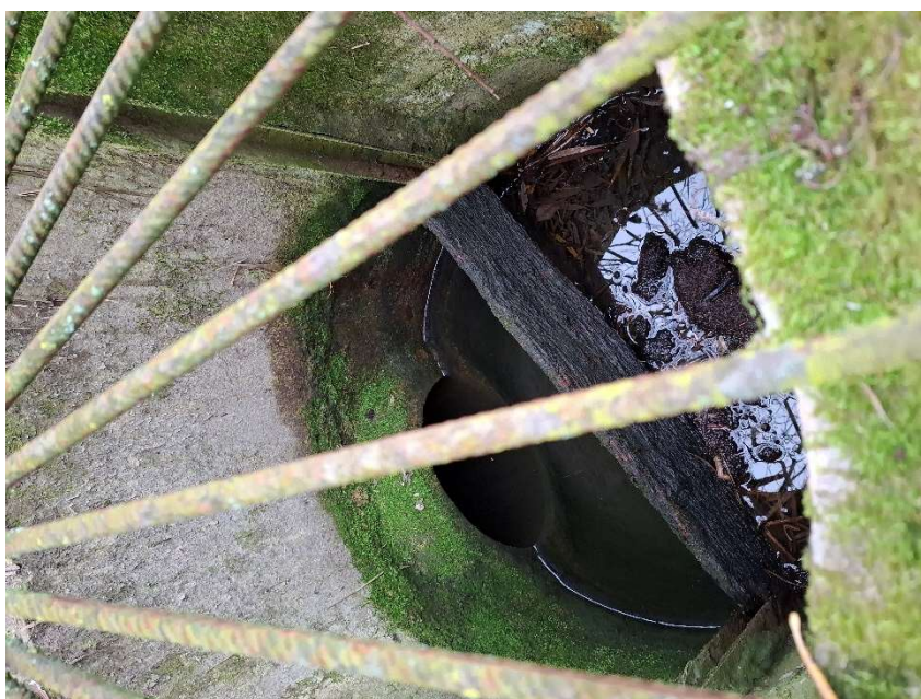
Bild 8. Utloppsbrunn är i behov av nya brädor då nuvarande bidrar till läckage.
